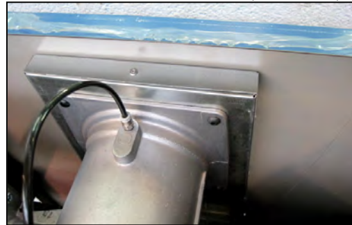
Vista del filtro montado en la caldera (desde arriba)
